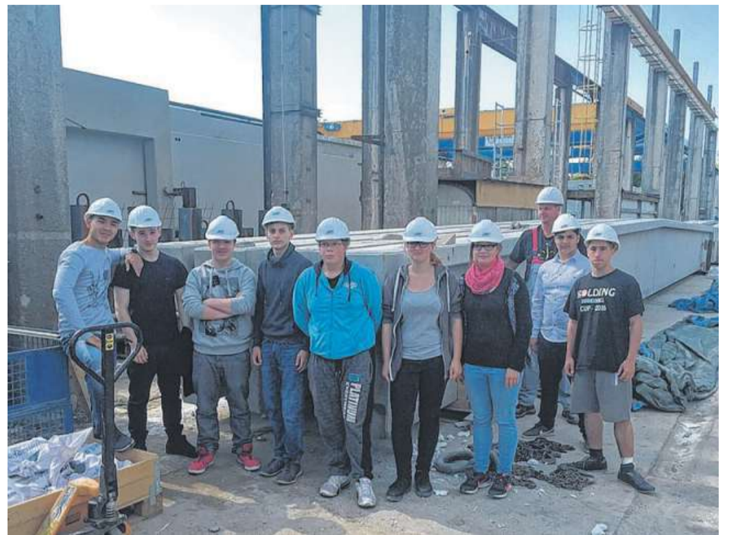
Schüler und Schülerinnen der Leintorschule unter der Aufsicht von Sven Küker (BKM) erleben den Ausbildungsberuf „Beton- und Stahlbetonbauer/in“.
